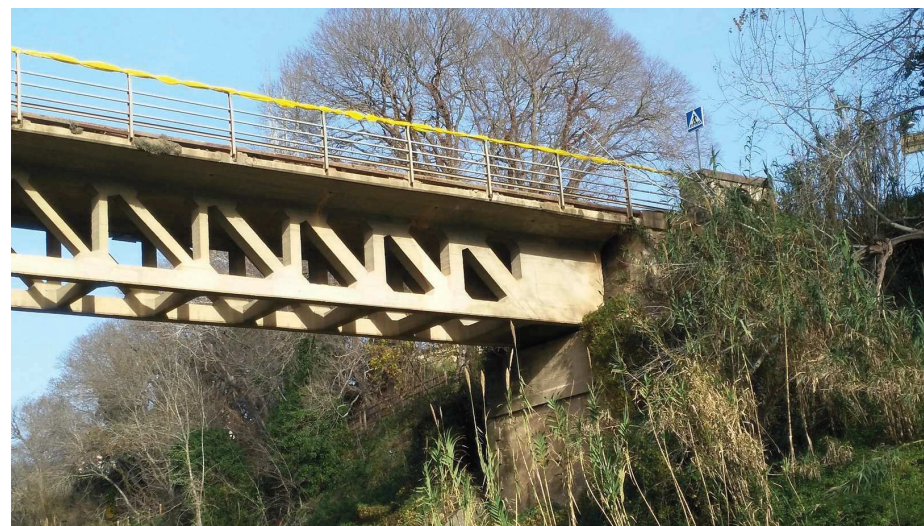
4. Estrep esquerre pont costat aigües avall. Aquí s'ha d'efer el nou estrep
